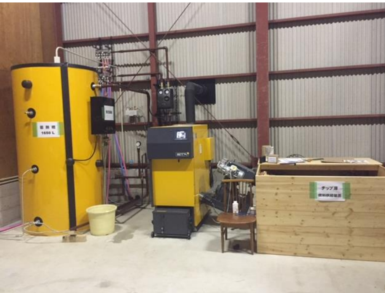
ラボ熱源施設
