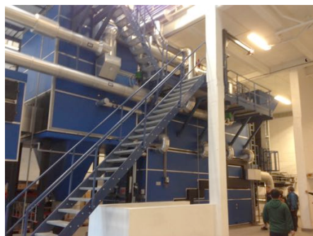
木質チップボイラー
